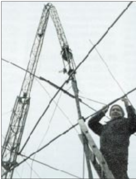
Wie ein Streichholz geknickt: Eine nette Über-raschung erlebte Martyn, G3UKV, im letzten Winter nach einem Sturm, als er seine 6-m-Antenne in etwas ungünstiger Lage vorfand.
